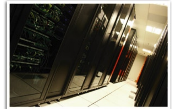
Infra-estrutura de ponta , em Internet DataCenter nacional.
